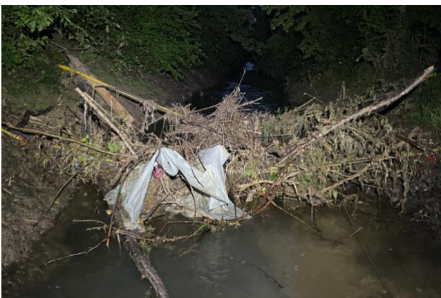
Abbildung 3-17: Antennen als Sammler von Geschwemmsel aller Art am Tegelbach (Nachteinsatz).
